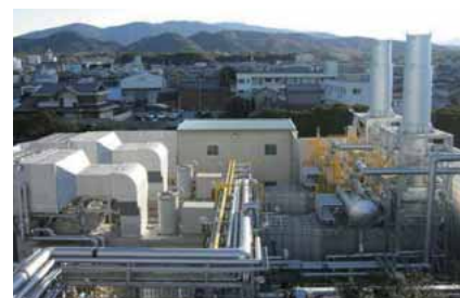
Sistema de cogeneración de la planta de Mito
